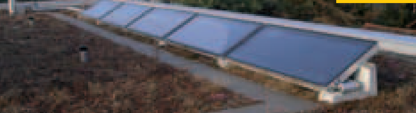
Panneaux thermiques de la crèche, toit végétalisé
