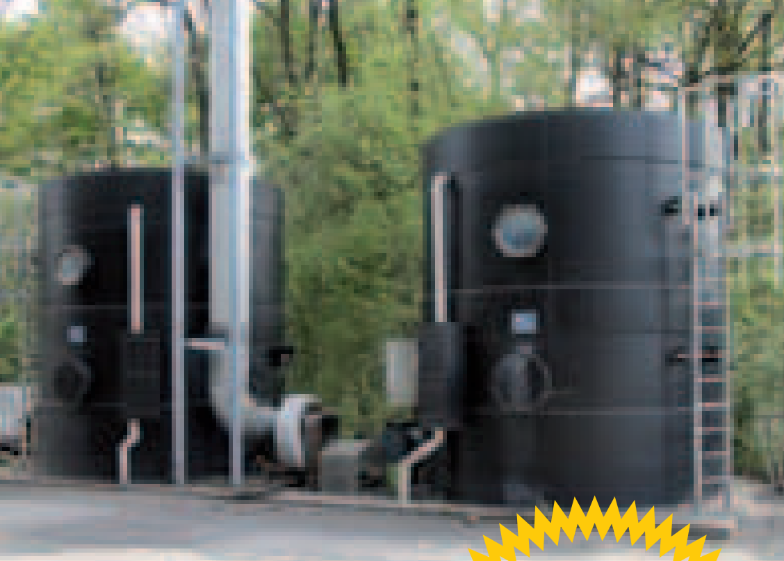
Les "digesteurs" du site de Châtillon
